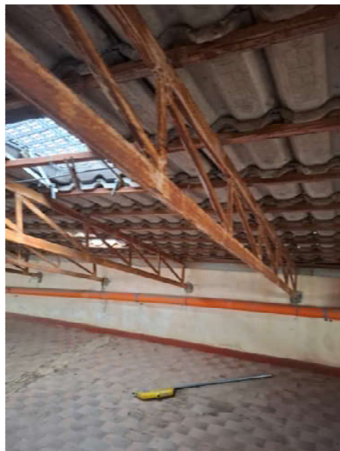
FOTO N.33 – PARTICOLARE STRUTTURA PRECARIA DI COPERTURA
